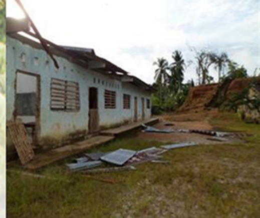
Afectación escuela Campo Bonito. Fotografía CMGR Quibdó
