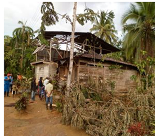
Afectación Vivienda. Fotografía CMGR Quibdó
